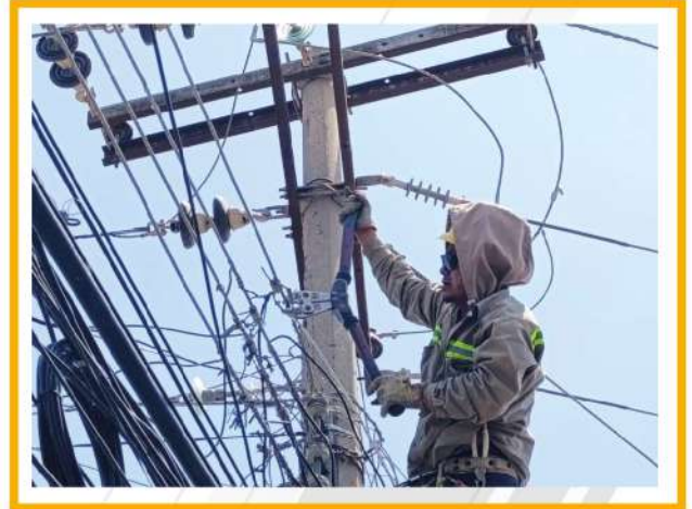
Instalaciones eléctricas de alta y media tensión. Imagen 16.2
